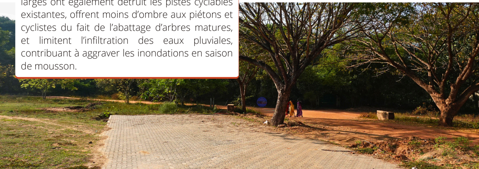
Route inachevée, février 2026 (la Fondation ne dispose pas des terrains requis pour compléter le réseau routier)
